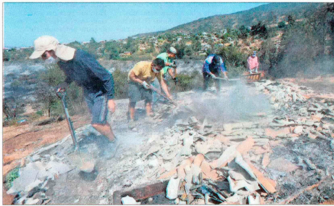
REMOCIÓN DE ESCOMBROS. — Las familias damnificadas por el incendio que afectó a 60 viviendas en Limache participaron ayer junto al municipio en el despeje de terrenos para instalar soluciones habitacionales de emergencia.
