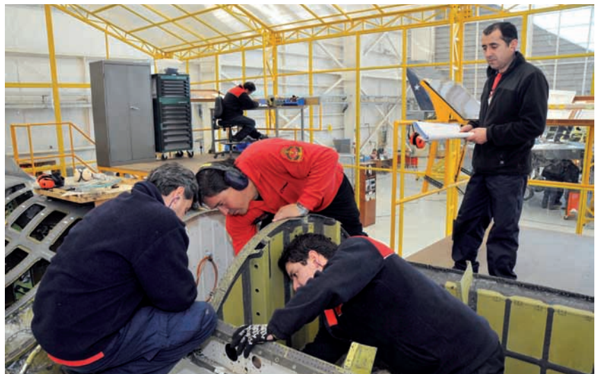
2ª etapa de modernización, que corresponde a la modificación estructural y eléctrica que requiere de un ambiente controlado en temperatura y humedad.
